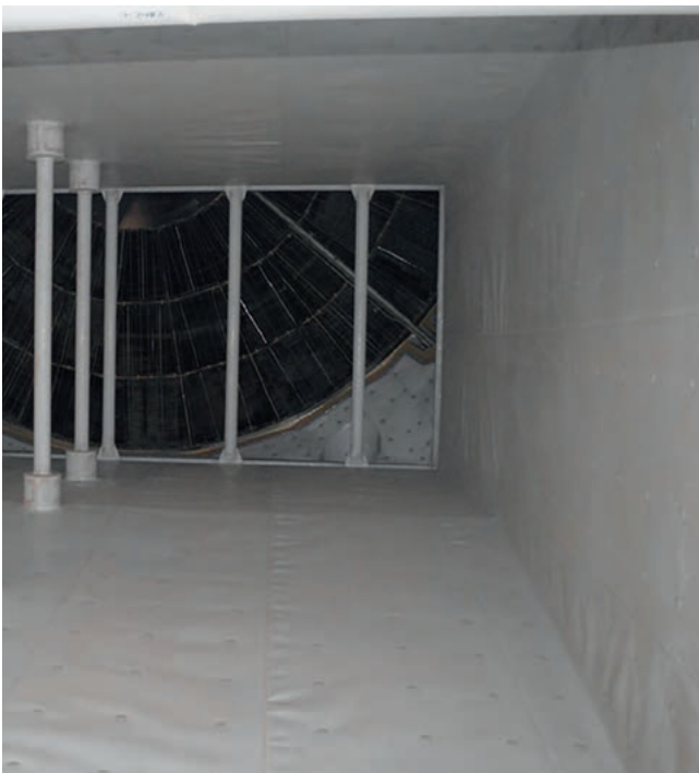
PTFE-M Auskleidung in einem Rohgaskanal
