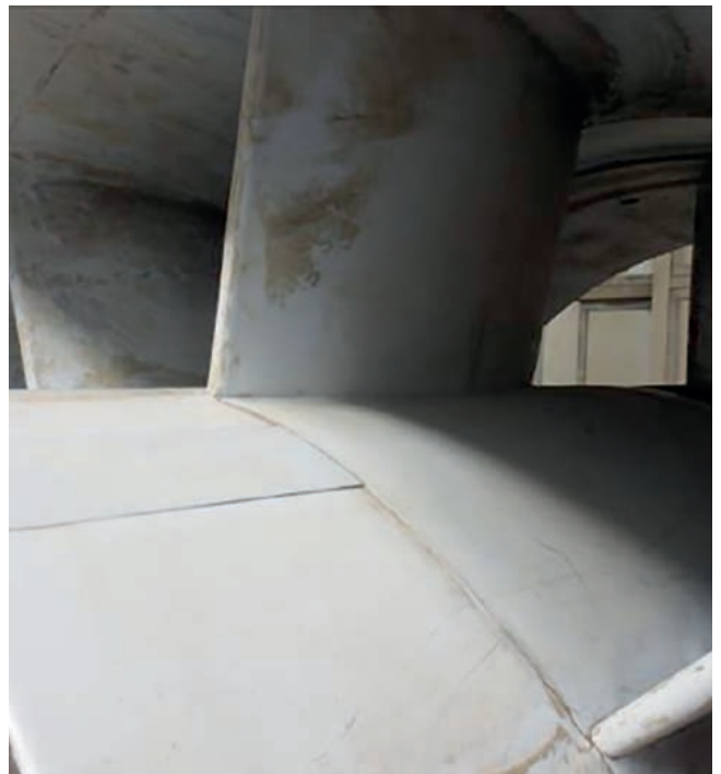
Remafon (PTFE) als Antihaftauskleidung in einem Rauchgasgebläse
